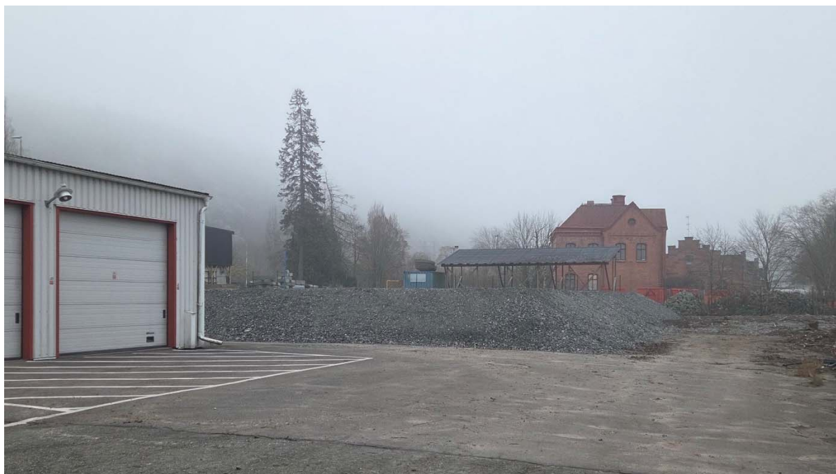
Bild 4. Vid undersökningstillfället hade markarbeten påbörjats inom den sydöstra delen av området. Marknivån hade höjts ca 2 meter med ett lager krossmaterial (GEO-gruppen AB, 2025).
